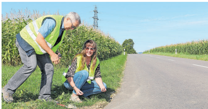
Er hält: Manfred Partl und Christiane Raab stellen fest, dass der kalt ausgebrachte Recycling-Asphalt das erste Jahr gut überstanden hat.
