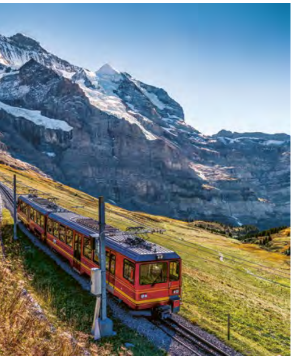
Travaux de renforcement par «Memory-Steel» au Jungfrauoch. Un chalumeau à gaz active l'alliage à mémoire de forme, rétablissant la précontrainte de l'acier. Images: re-fer, iStockphoto
