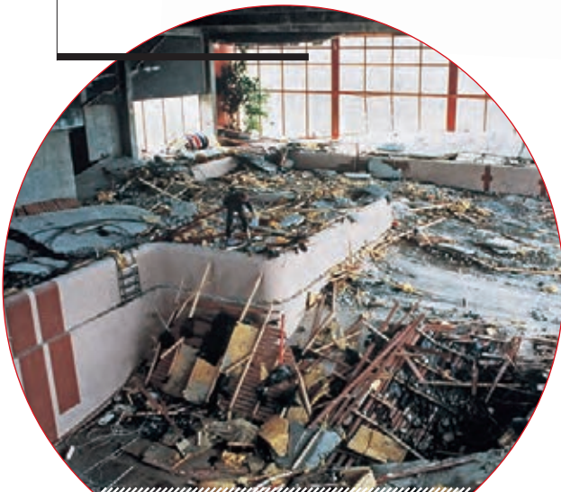
Deckeneinsturz im Hallenbad Uster
