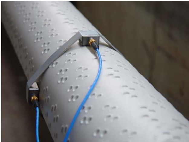
Beschleunigungssensoren messen die Seilschwingungen in vertikaler und horizontaler Richtung.
