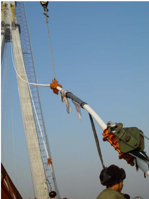
Einbau des zehnten, 228 Meter langen Seils auf der Sutong-Brücke über den Yangtse.
