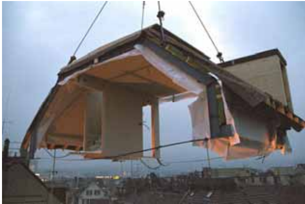
Elément de toiture préfabriqué lors des travaux de rénovation modèles d'un bâtiment à la Magnusstrasse à Zurich (Architecte K. Viridén, Zurich).
